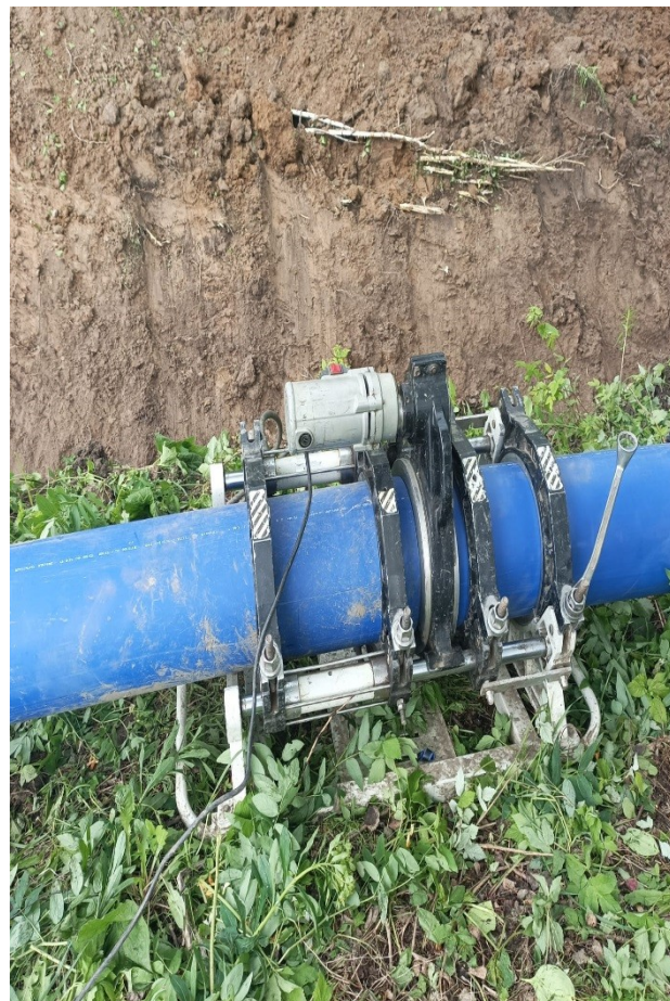
Центральные водопроводные сети, пгт Зеленогорский
